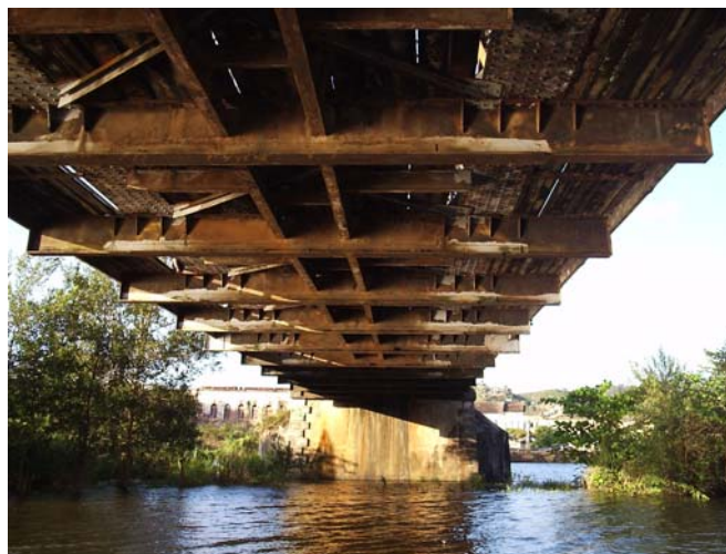
Figura 1 – Corrosão na estrutura de ponte metálica no interior da Bahia, Brasil.
