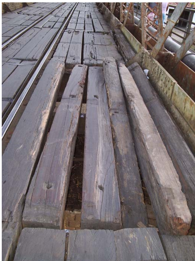
Figura 3 - Descontinuidade na pista de ponte no interior da Bahia, Brasil.
