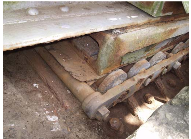
Figura 2 – Aparelho de apoio danificado por processo corrosivo em ponte no interior da Bahia, Brasil.
