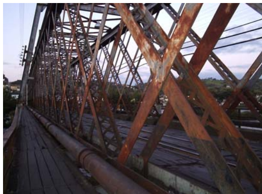
Figura 4 - Corrosão em elementos da superestrutura de ponte no interior da Bahia, Brasil.
