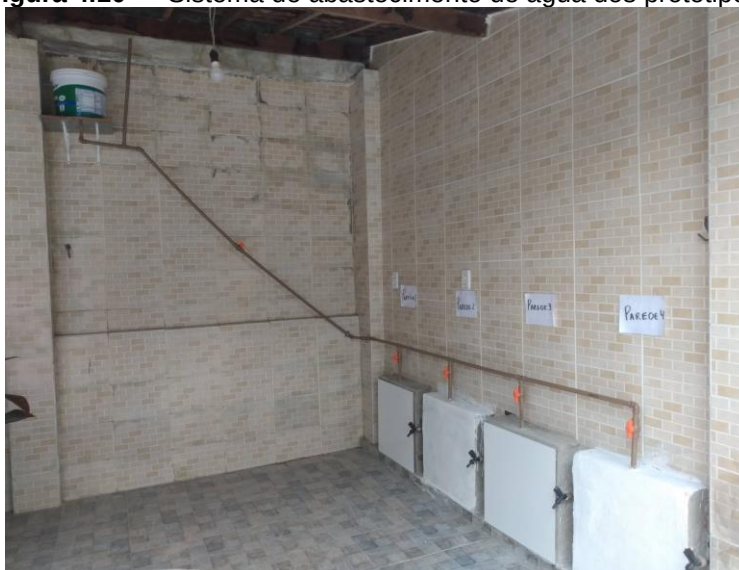
Figura 4.10 — Sistema de abastecimento de água dos protótipos.
