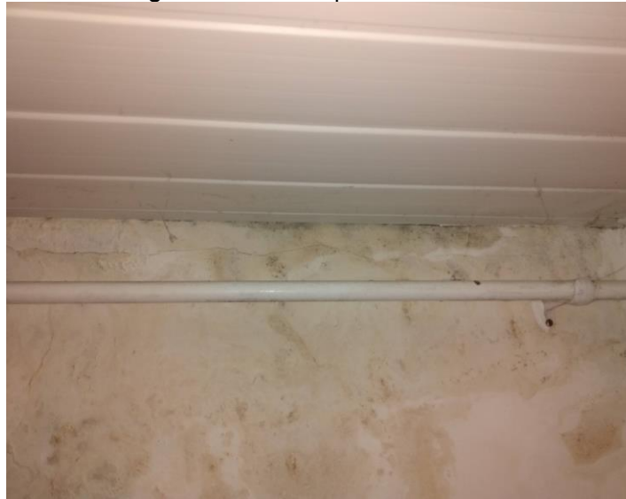
Figura 3.4 — Mofo próximo ao forro.
