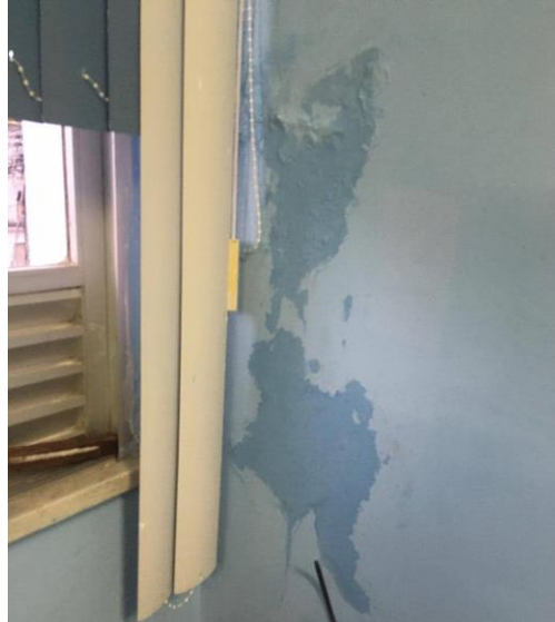
Figura 3.3 — Mancha de umidade na parede interna
