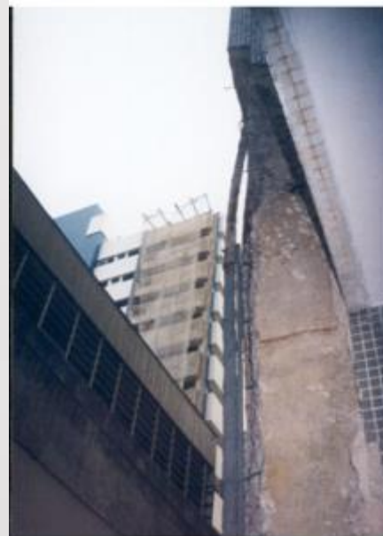
Flambagem de barras em um pilar por corrosão dos estribos
