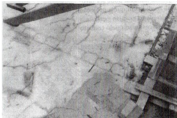
Figura 5. Laje de concreto apresentando fissuras decorrentes do processo de retração plástica e do processo de sedimentação.
